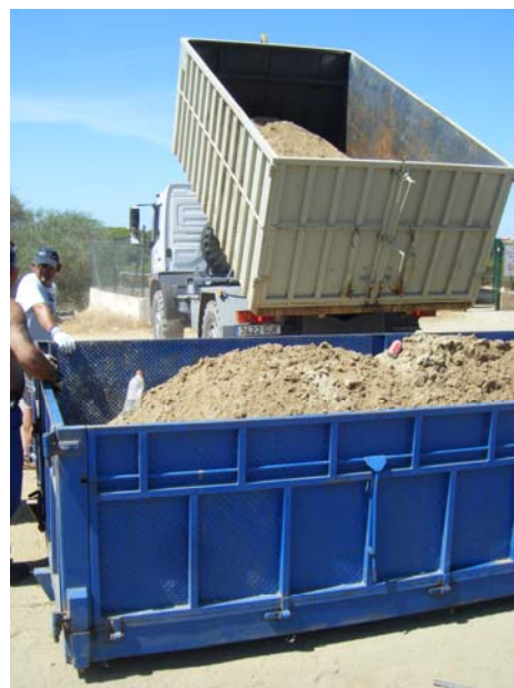
Descarga del vertido en los contenedores de Matalascañas
