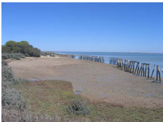
Signos de la erosión en los márgenes del Guadalquivir
