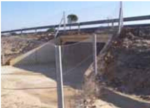
Paso de fauna de la Rocina
