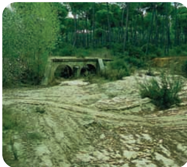
Colmatación de obra de paso del arroyo de Cañada Mayor.
